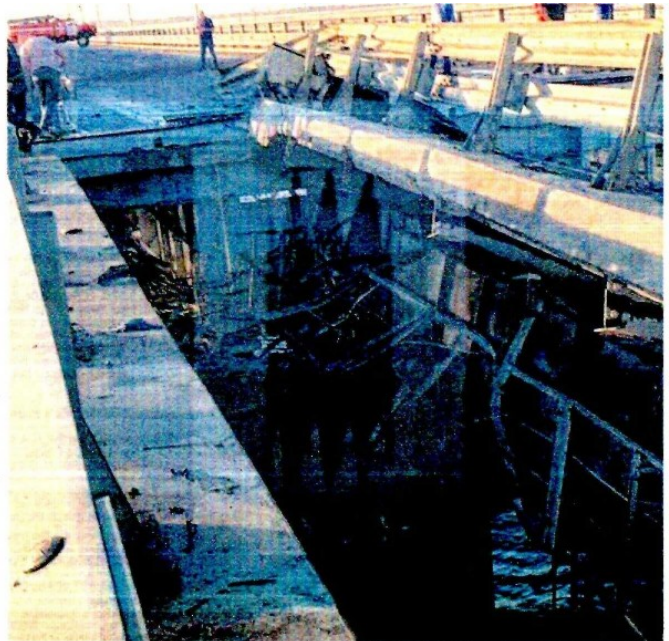
Daños. Así quedó el puente Kerch, que une Crimea con Rusia tras el bombardeo.
