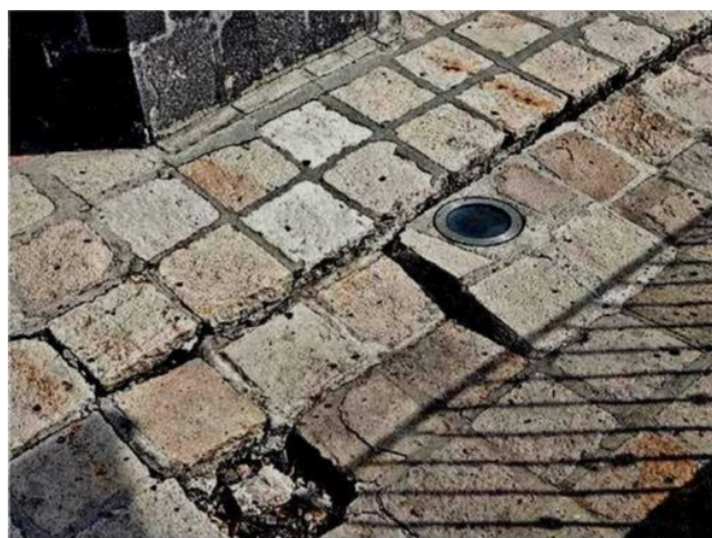
Debido al sismo, también en las aceras de los templos se registran fallas que representan un peligro para transeúntes.
