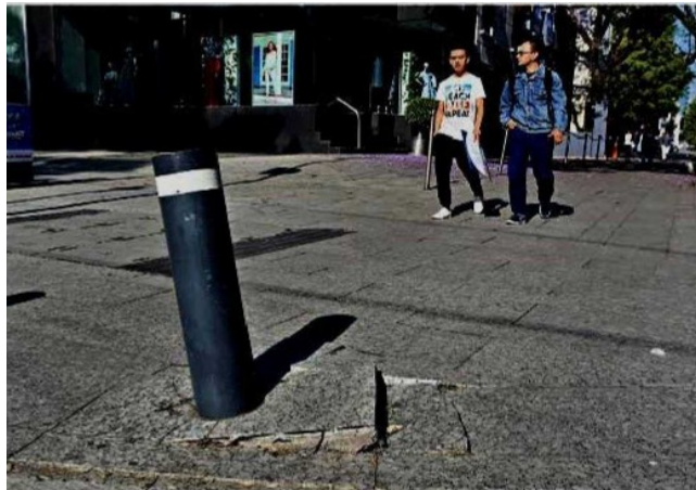
■ Con el paso de los días la infraestructura urbana sufre diversos daños, por lo que se le debe de dar mantenimiento.
